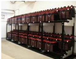
Batterieanlage (OPzS) auf Gestellen montiert.
